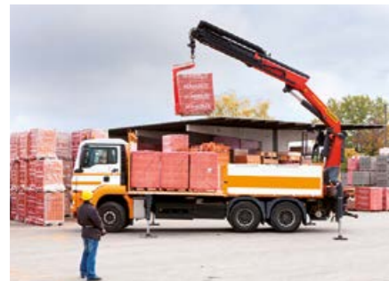
S3 – grues de chargement
